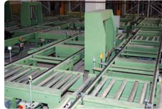
Die Schreib-/Leseköpfe sind in direkter Nähe zu den Transportbändern angebracht und erfassen die Datenträger an den Transportbehältern.
